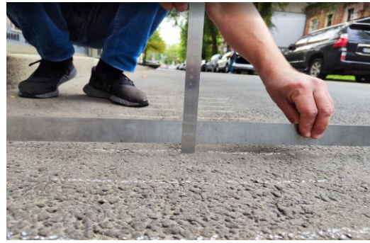
Рис. 3. Інструментальне вимірювання дефекту дорожнього одягу
