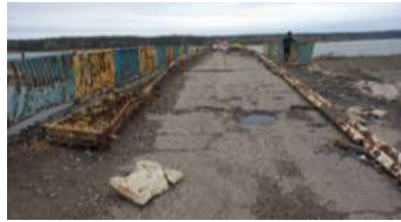
Рис. 5. Руйнування мостового полотна без руйнування балок та опор мосту через бойові дії в Харківській області
