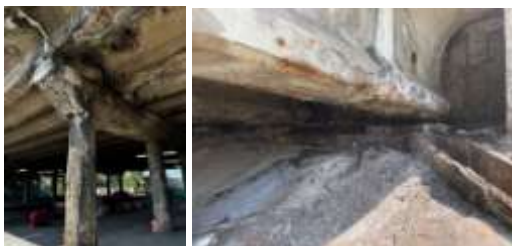
Рис. 2. Стан шляхопроводу на перетині вул. Лугової та Богатирської до ремонту
