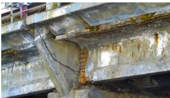
Рис. 2. Руйнування мосту через корозію арматури
