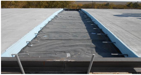
Рис. 2. Подвійний шов розширення, влаштований на покритві автомобільної дороги Н-14
