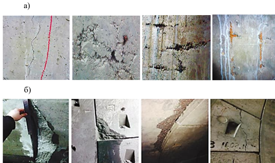
Рис. 1. Тріщини, відколи, вибоїни, порушення захисного шару конструкцій тунельних оправ, зведених з: а – монолітного бетону, б – високоточних залізобетонних блоків
