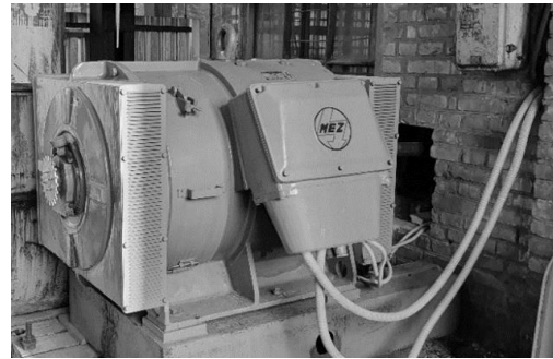
Рис. 2. Привод станда потужністю 400 кВт
