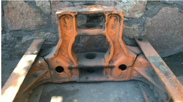
Рис. 2. Руйнування опори вертикального шарніра
