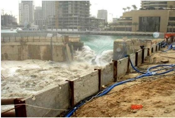
Рис. 3. Аварія під час влаштування котловану в Дубаї
