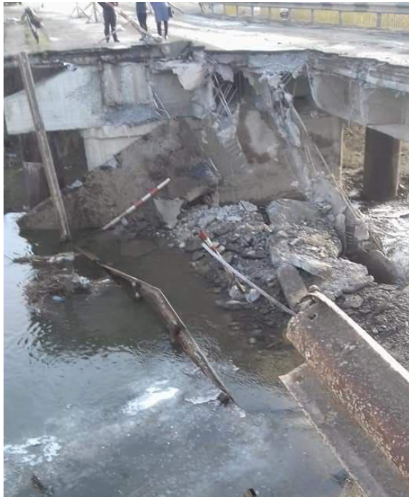
Рис. 1. Загальний вигляд обваленого прольоту моста (вид на опору №3)
