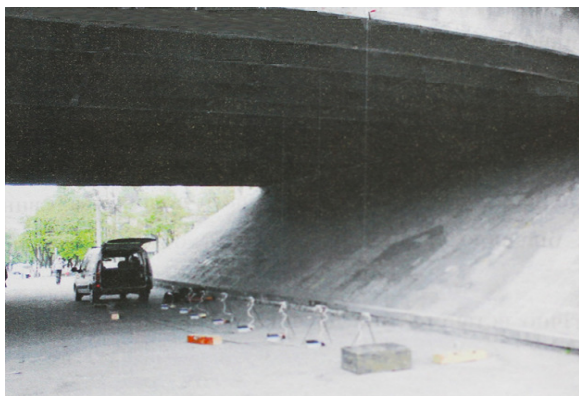
Рис. 8. Анкерне закріплення струни (дроту) датчика деформації на проїзній частині дороги під шляхопроводом
