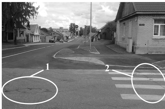
Рис. 1. Асфальтобетонное покрытие городской улицы: 1 – продольные трещины; 2 – поперечные трещины
